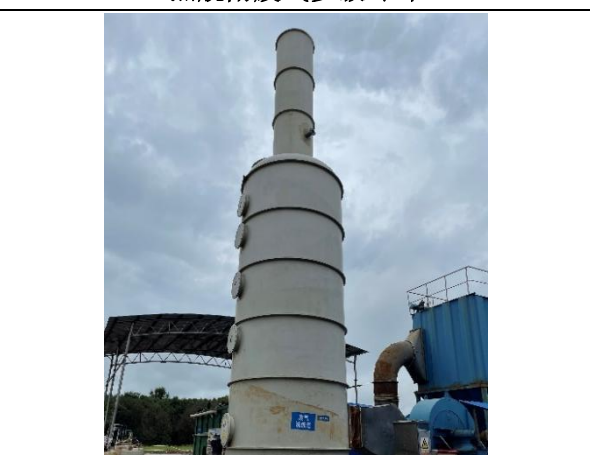
热脱附废气喷淋塔+20m 高排气筒
