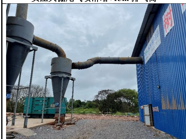
热脱附废气处理二级旋风除尘
