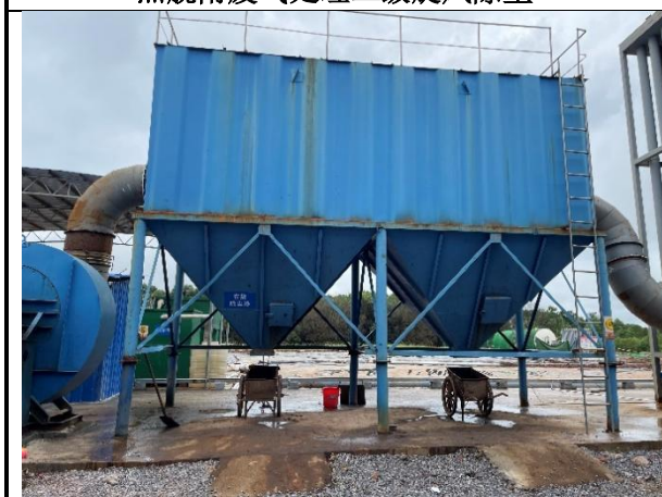
热脱附废气布袋除尘器
