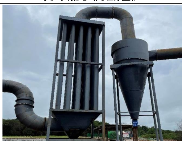
热脱附废气多级冷却
